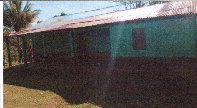
Foto 2: Se observa en mal estado del entechado.
